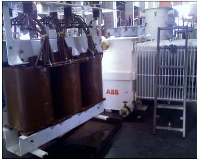
Figura 4.2 - Transformador TA aberto na oficina.
