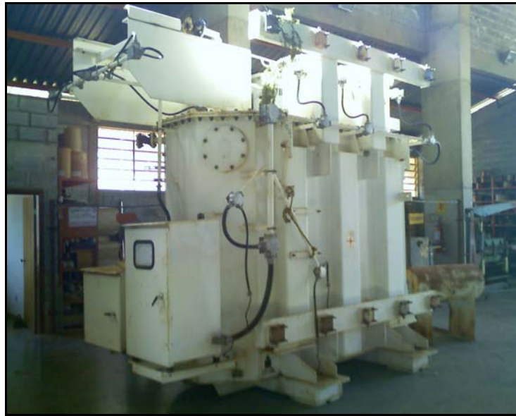
Figura 4.7 - Transformador TB nas dependências da oficina.
