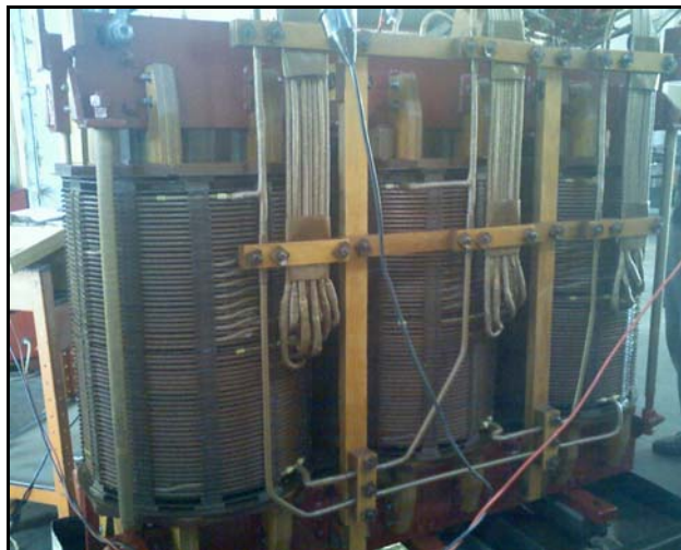
Figura 4.19 - Parte ativa do transformador TD.
