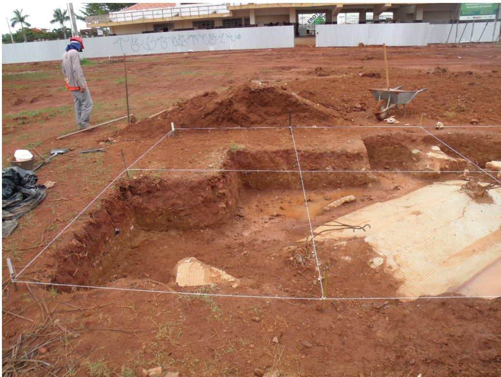
Foto 2 -Ruína do Monumento ao Trabalhador que surgiu após a retirada das palmeiras imperiais durante obra de restauro do sítio da antiga Estação Ferroviária de Goiânia. Foto: Relatório IPHAN -2018
