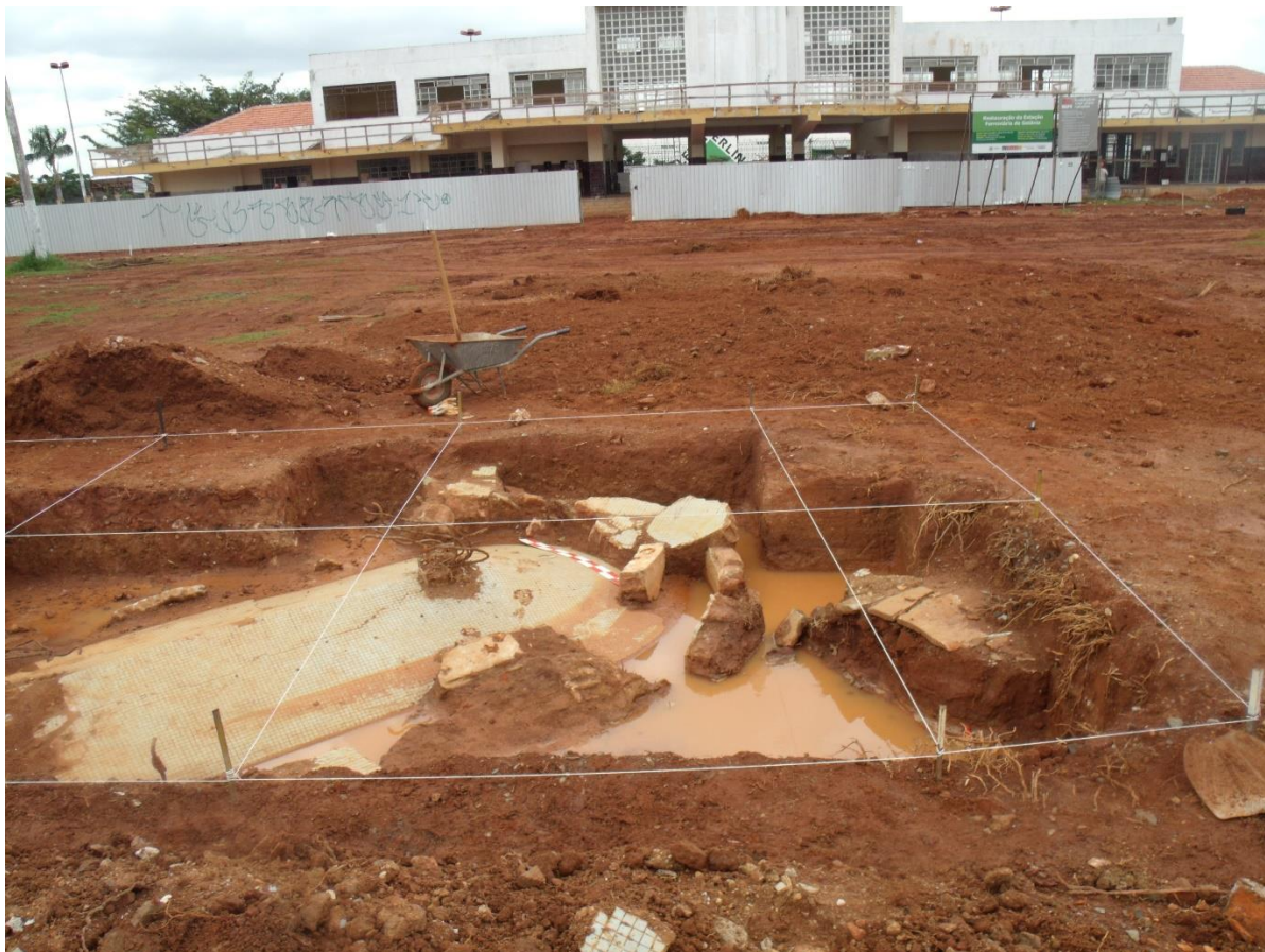
Foto 3 - Ruína do Monumento ao Trabalhador que surgiu após a retirada das palmeiras imperiais durante obra de restauro do sítio da antiga Estação Ferroviária de Goiânia. Foto: Relatório IPHAN -2018
