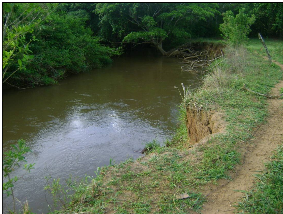
Fig.04: Atuais condições encontradas as margens do Caldas. Fonte: Trabalho de Campo, 17 de outubro de 2009.
