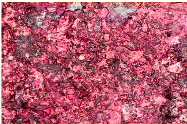
Figura 4.13 - Ferrugem da viga acima em microscópio óptico Fonte: Autor
