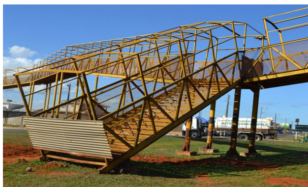
Figura 1.18 - Interdição da passarela
