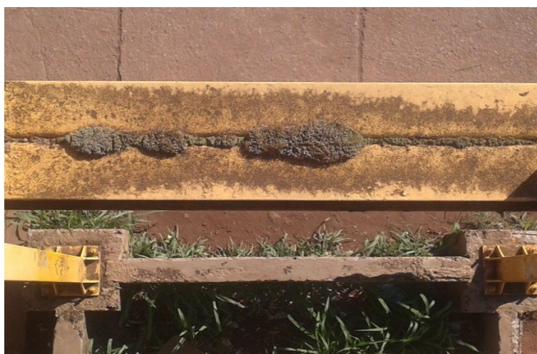
Figura 4.5 - Corrosão Microbiológica. Ver itens 2.5.1.4 e 2.6.2 Fonte: Autor
