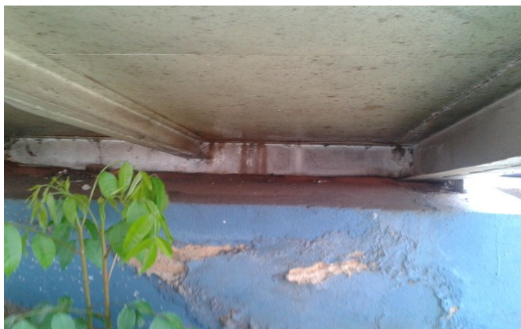
Figura 4.33 - Laje com escoamento de água da Passarela 2. Ver item 2.5.1.4 e 2.5.1.11 Fonte: Autor
