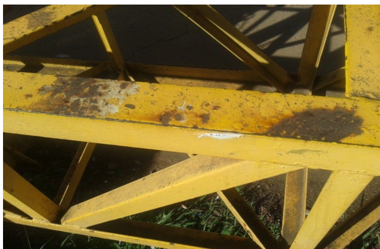
Figura 4.2 - Partes da estrutura sem pintura enferrujando Fonte: Autor
