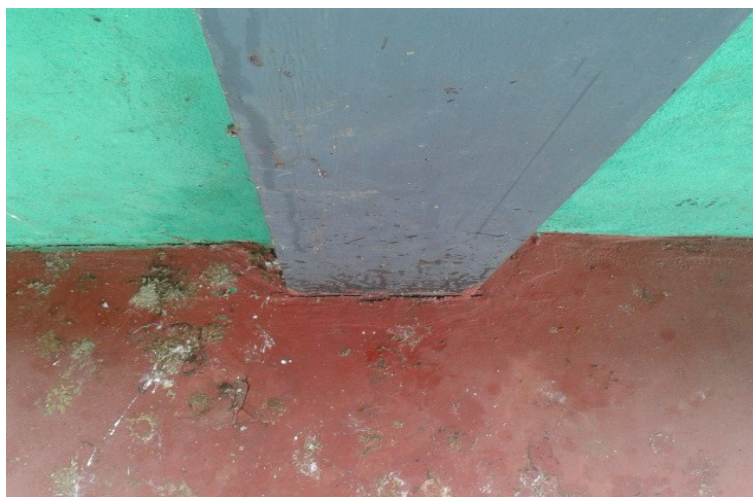
Figura 4.24 - Fezes na base do pilar da quadra. Ver item 1.1.2.1 Fonte: Autor
