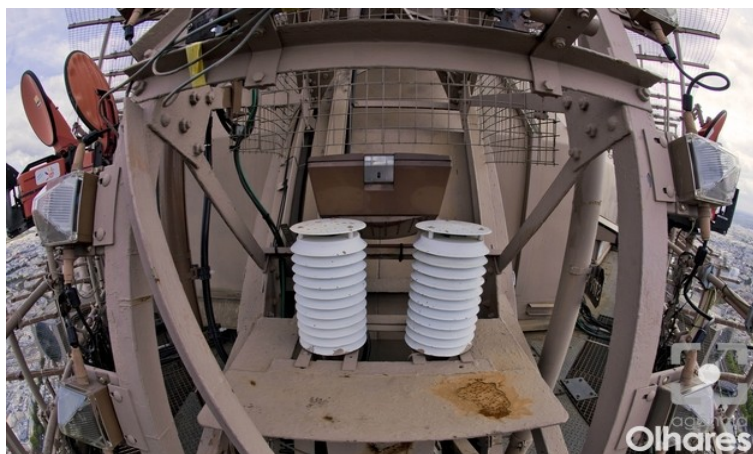
Figura 1.3 - Detalhe de corrosão Fonte: (AGÊNCIA OLHARES, 2009d)
