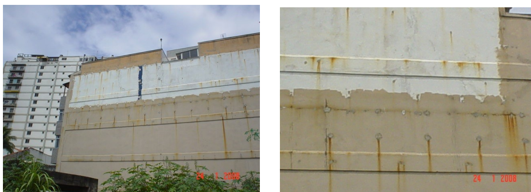
Figura 2.28 - Empena, após a remoção da publicidade com vários pites de corrosão Fonte: (ZAPLA et al, 2008)
