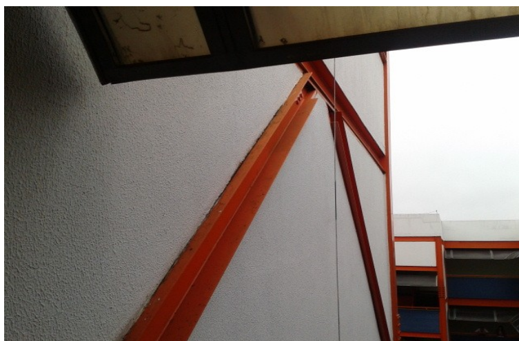
Figura 4.20 - Viga da caixa da escada do bloco S. Ver item 2.5.1.4 e 2.1.5.1.13 Autor
