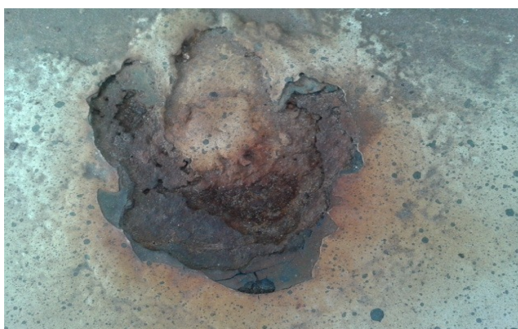
Figura 4.41 - Corrosão na base do pilar. Ver item 1.1.2.1 Fonte: Autor
