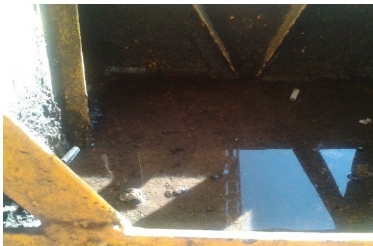
Figura 4.6 - Água no pé do pilar. Ver itens 2.5.1.1 , 2.5.1.4 , 2.5.1.16 , 2.5.1.12 e 2.5.1.13 Fonte: Autor
