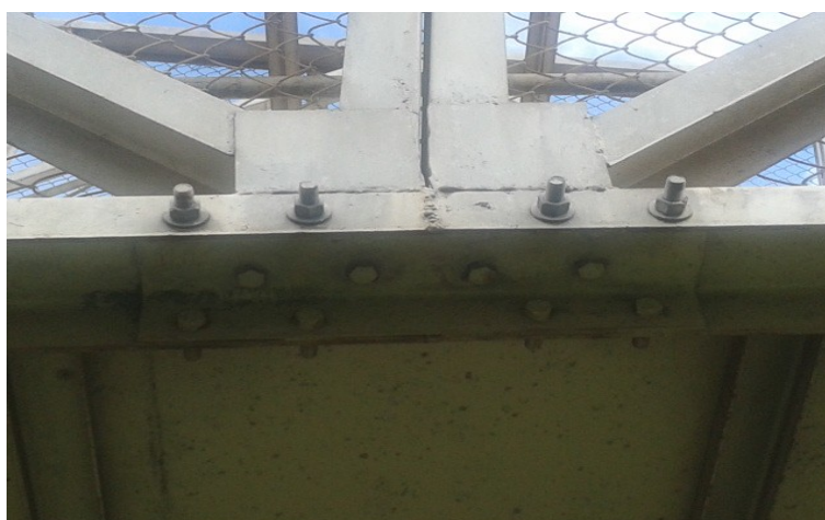
Figura 4.39 - Frestas nas vigas da Passarela 4. Ver item 2.5.1.11 Fonte: Autor
