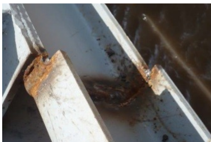
Figura 2.63 - Verificação em campo de juntas incorretas Fonte: (SANCHES, 2010)
