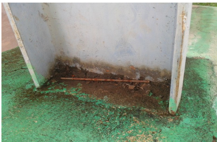
Figura 4.23 – Pó no pé do arco da quadra. Ver item 2.5.1.4 e 2.5.1.6 Fonte: Autor
