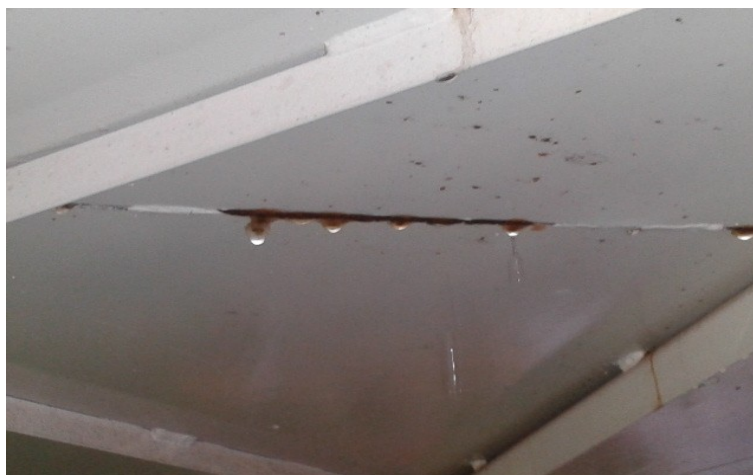
Figura 4.36 - Frestas na laje da Passarela 3. Ver item 2.5.1.11 Fonte: Autor
