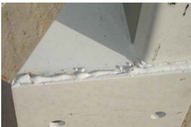
Figura 2.67 - Junta com Mordedura Falta de Fusão e Respingos. Fonte: (NOVAIS, 2010)
