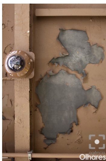
Figura 1.4 - Detalhes do descascamento
