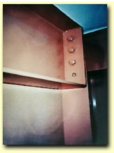
Figura 2.50 - Falta de furo no pilar Fonte: (CASTRO, 1999)
