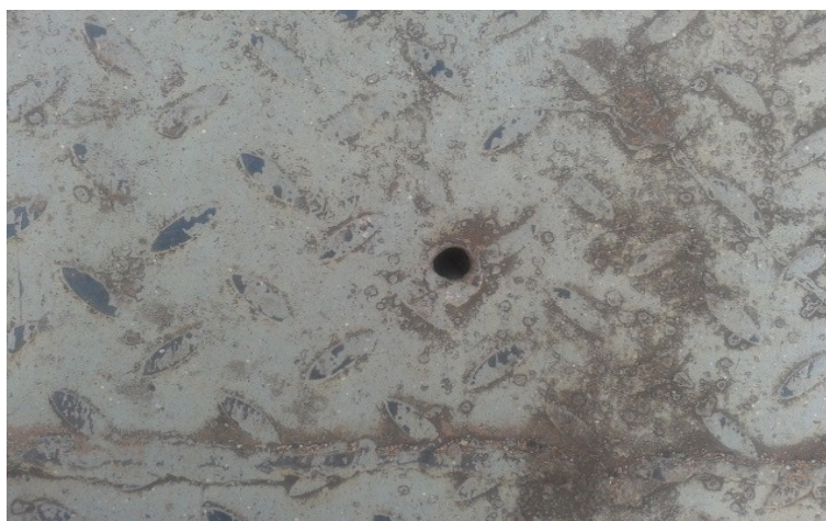
Figura 4.28 - Furo na laje da Passarela 1. Ver item 2.5.1.13 Fonte: Autor
