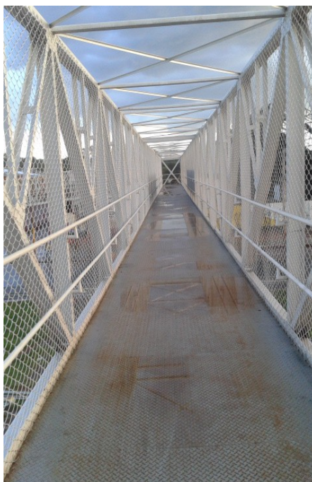
Figura 4.37 - Laje com empossamento de água da Passarela 3, Ver item 2.5.1.4 e 2.5.1.11 Fonte: Autor
