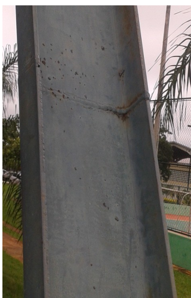
Figura 4.25 - Ferrugem na solda do arco da quadra. Ver item 1.1.2.2 e 2.5.1.9 Fonte: Autor
