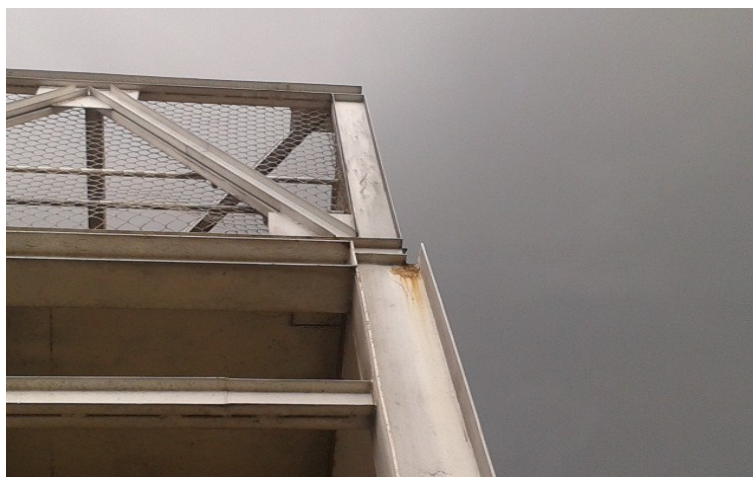
Figura 4.32 - Cabeça do pilar com ferrugem na Passarela 2. Ver item 5.5.11 Fonte: Autor
