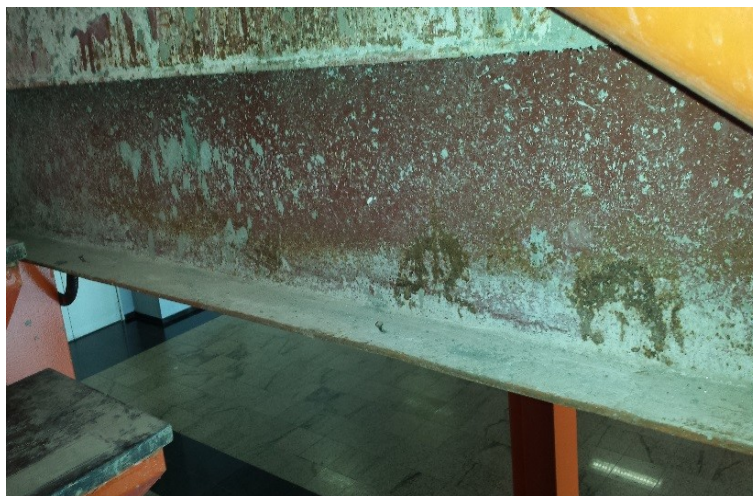
Figura 4.12 - Viga da escada do bloco G. Ver item 2.1.5.4 Fonte: Autor
