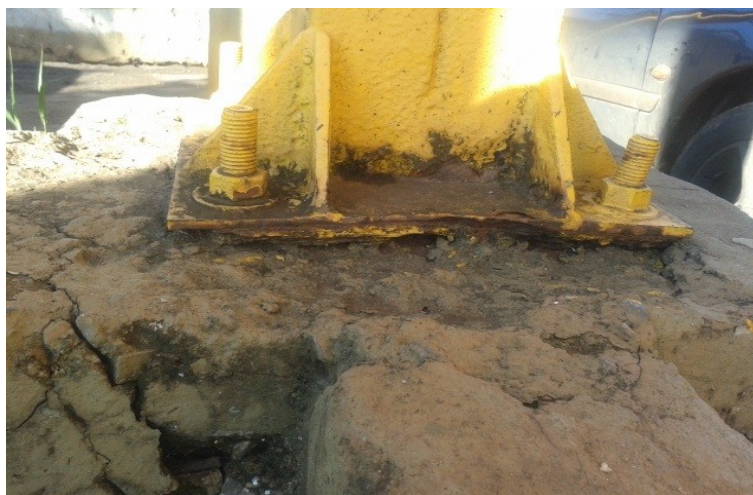
Figura 4.7 - Corrosão por frestas no pé do pilar. Ver itens 2.5.1.4 , 2.5.1.6 e 2.5.1.13 Fonte: Autor
