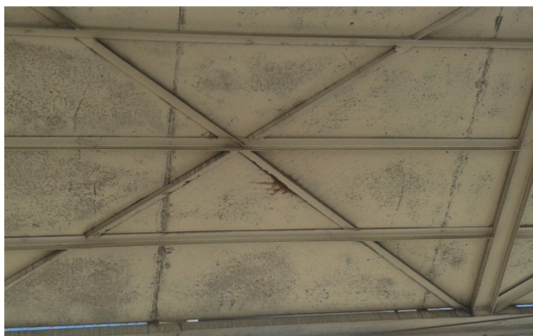
Figura 4.40 - Frestas na laje da Passarela 4. Ver item 2.5.1.11 Fonte: Autor
