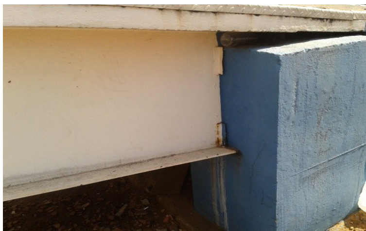
Figura 4.29 - Viga com escoamento de água da Passarela 1. Ver item 2.7.6 Fonte: Autor
