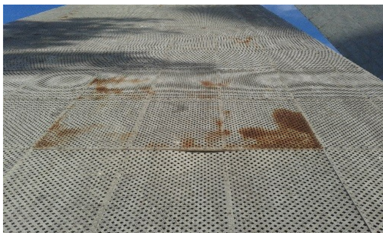
Figura 1.15 - Corrosão de placas do obelisco Fonte: Autor
