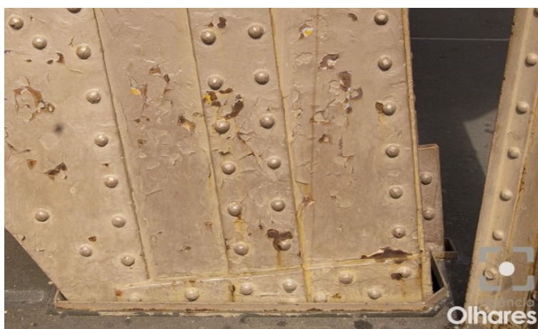
Figura 1.2 - Detalhe do estado da pintura
