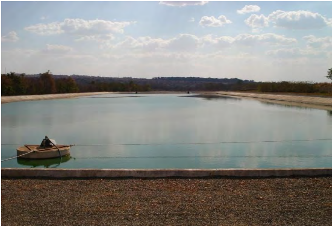
Figura 22 Vista panorâmica da Lagoa Facultativa da ETE Samambaia, de onde é coletado o esgoto para aplicação nos módulos de tratamento. No lado esquerdo, a bóia que sustenta a bomba de aplicação do esgoto.
