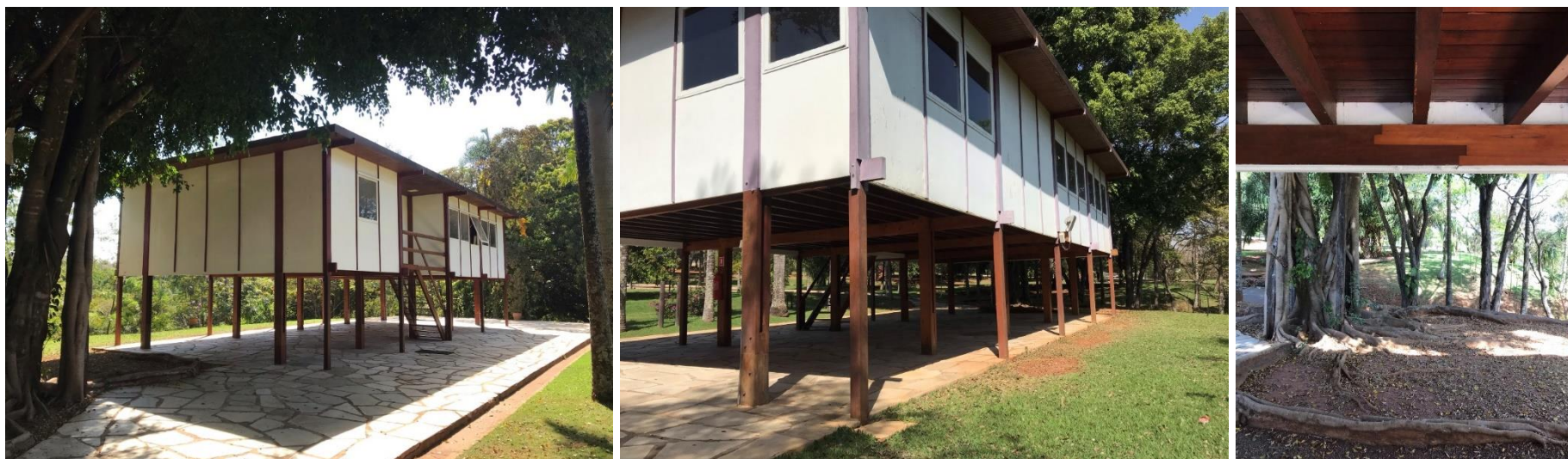
Figura 141: O pavilhão se destaca na paisagem do clube e cria cenas emolduradas pelas estruturas do térreo que precisou de reforço estrutural com duas linhas de pilares, bem como a substituição de parte de uma das vigas. Fonte: elaborado pelo autor (2023).
