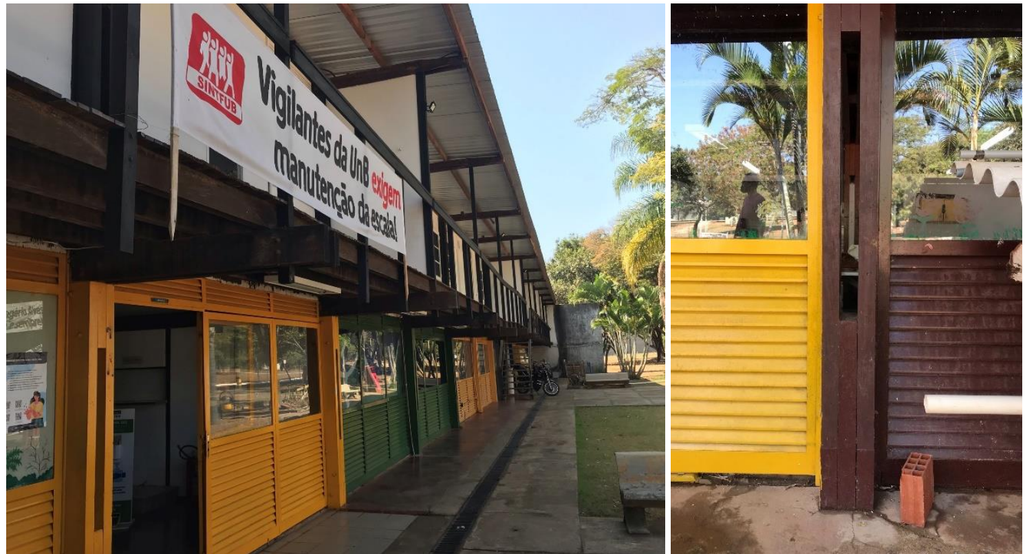
Figura 88: Fachada principal do OCA II com ênfase nas portas acrescentadas ao pavimento térreo. Fonte: elaborado pelo autor (2023).
