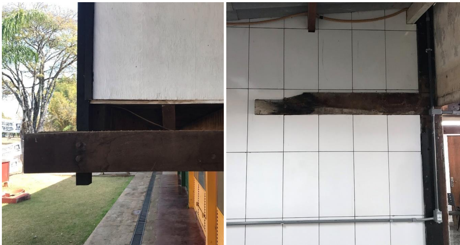
Figura 87: À esquerda, detalhe da orelha na fachada principal e à direita ampliação do edifício para a criação de uma cozinha onde a orelha foi incorporada à alvenaria. Fonte: elaborado pelo autor (2023).
