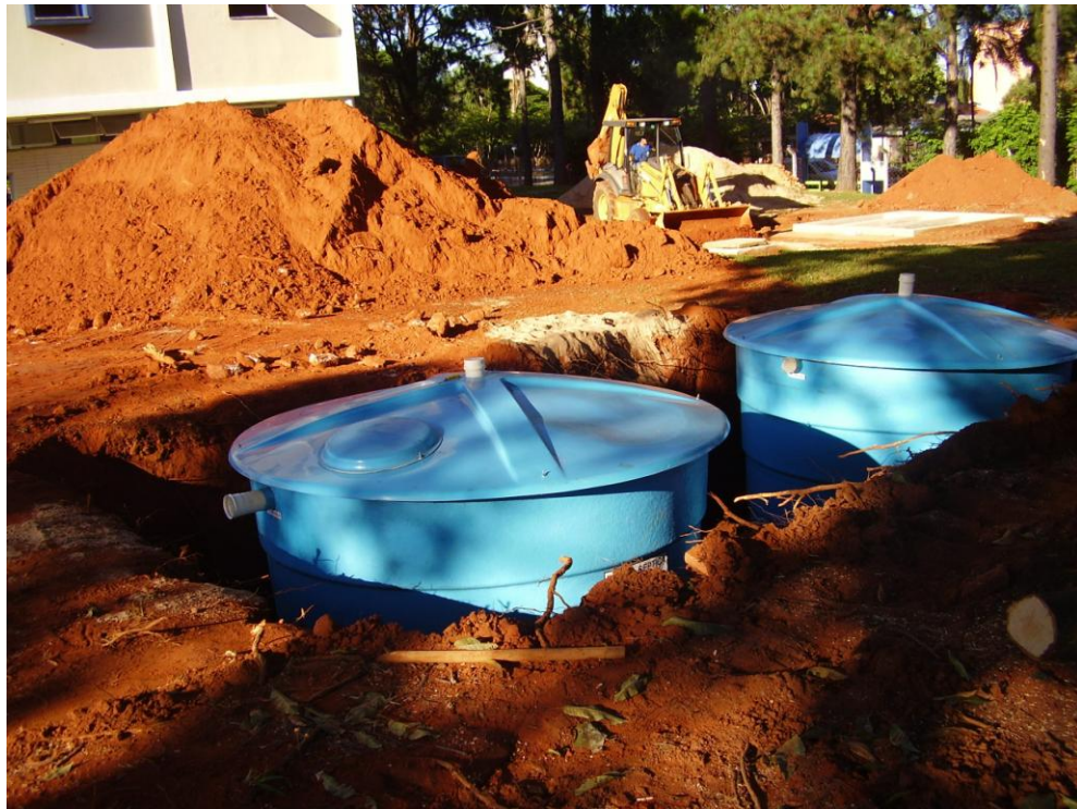
Figura 16 Detalhe do tanque séptico e filtro anaeróbio implantados como unidades de pré-tratamento da estação experimental de tratamento de esgoto da unidade universitária EE-UFG.
