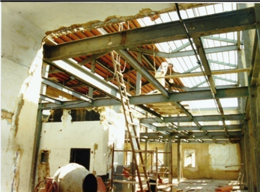
Imagem 29: Os pilares, vigas e tesouras em estrutura metálica se unem à caixa da escada para compor toda a estrutura da reforma. Fonte: Arquivo Biblioteca Cora Coralina.
