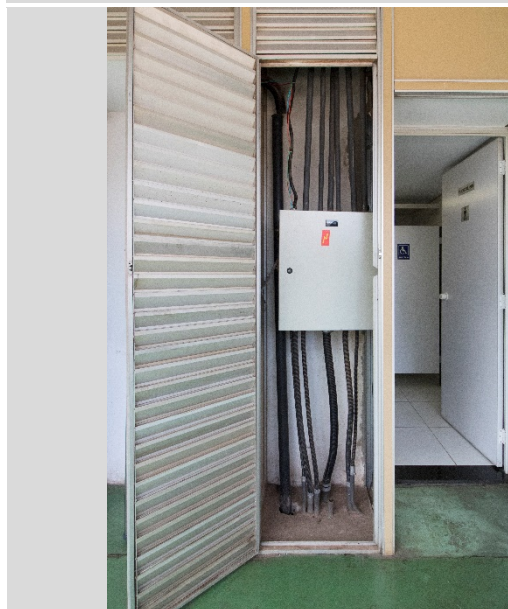
Figura 4.3-13 Shaft Elétrico Fonte: Acervo fotográfico do autor
