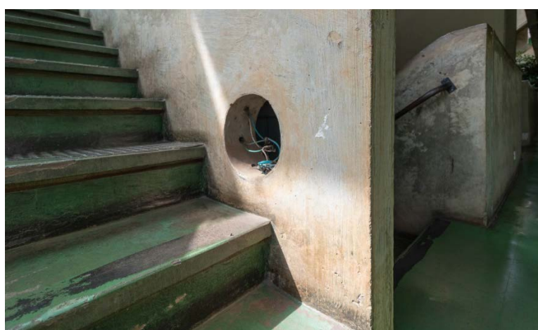
Figura 4.2-16 Luminária em guarda corpo Fonte: Acervo do autor
