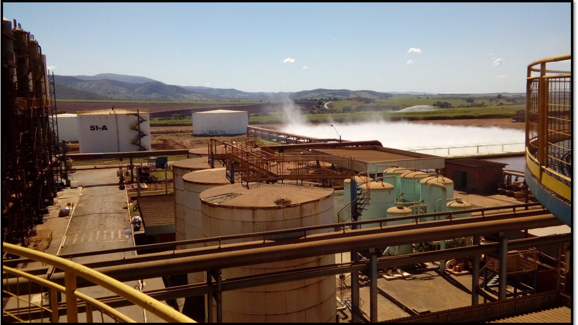
Imagem 27: Caldeiras de armazenamento de agroindústria goiana
