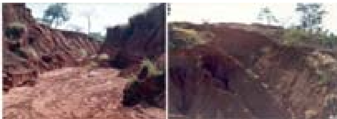
Figura 10: Erosão em área de nascente - 1998 - Rio Verde / GO
