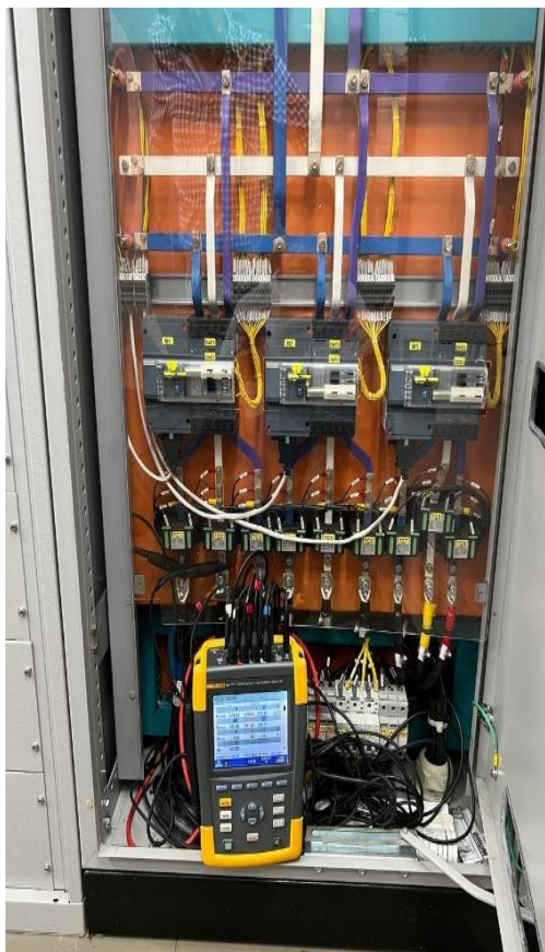
Figura 3.4 – Medições de campo utilizando o analisador Fluke 435-II da UFG
