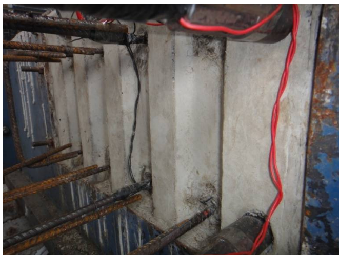
Figura 3.6 - Interface pilar-consolo com as chaves de cisalhamento no modelo M4, antes da concretagem do consolo.
