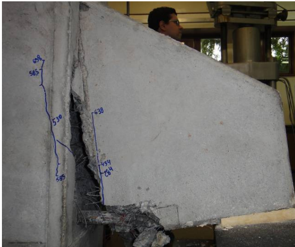
(b) Ruína do consolo 1 com abertura excessiva da junta e, conseqüentemente, ruptura do tirante.
