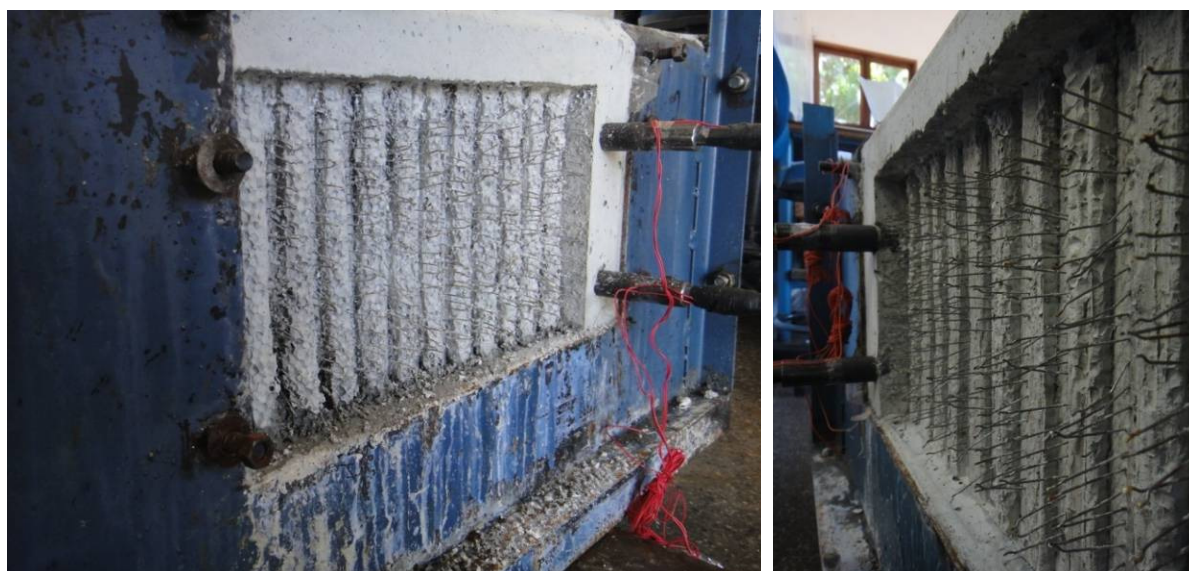
Figura 3.20 - Pilar do modelo M8 com as fibras expostas na junta entre o consolo e o pilar
