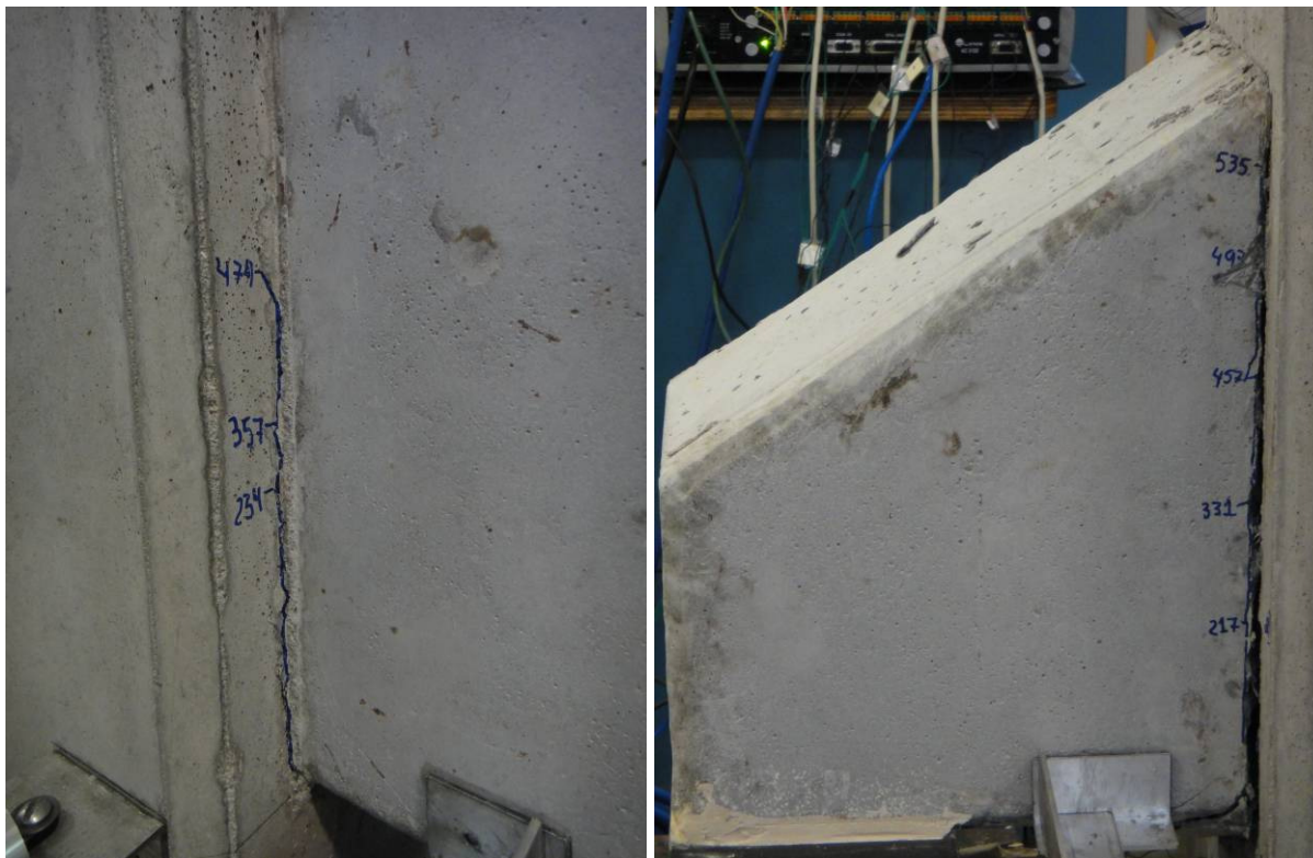
(a) Fissuração no consolo 1 ao final do ensaio
