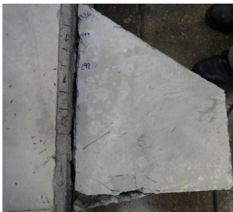
(c) Consolo 2 rompido por corte direto
