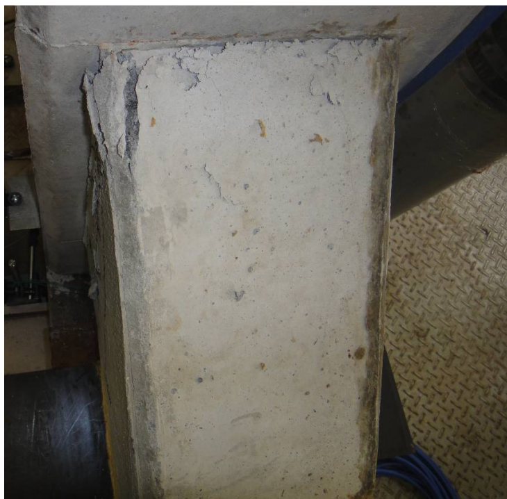
(e) Esmagamento do concreto no canto superior do consolo 2 ao final do ensaio
