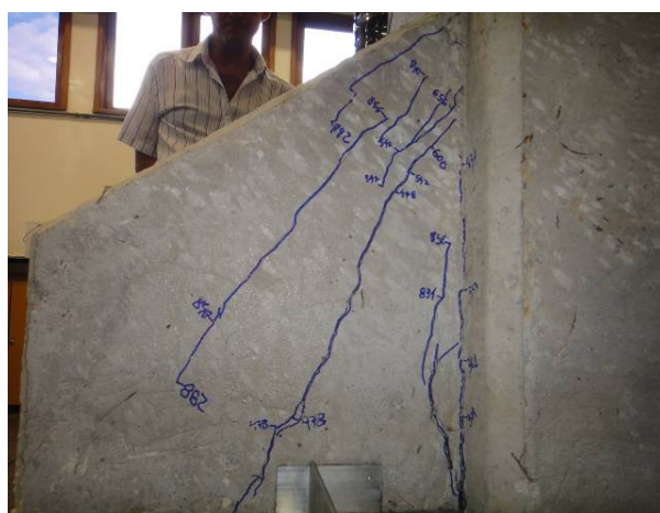
(c) Esmagamento da biela no consolo 1 ao final do ensaio
