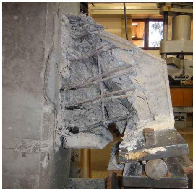
(e) Expulsão do cobrimento da armadura de costura do consolo
