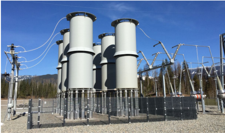
Figura 2.4 – Reator Shunt de núcleo de ar do tipo seco.
