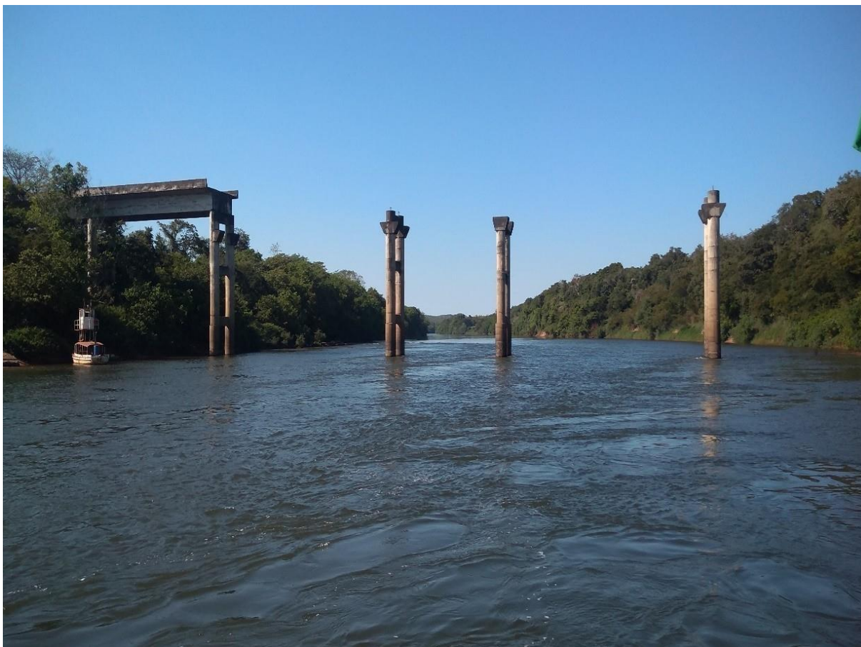
FIGURA 15 – Ponte embargada pela justiça federal, Rio Sono-TO. Fonte: o autor (2021).
