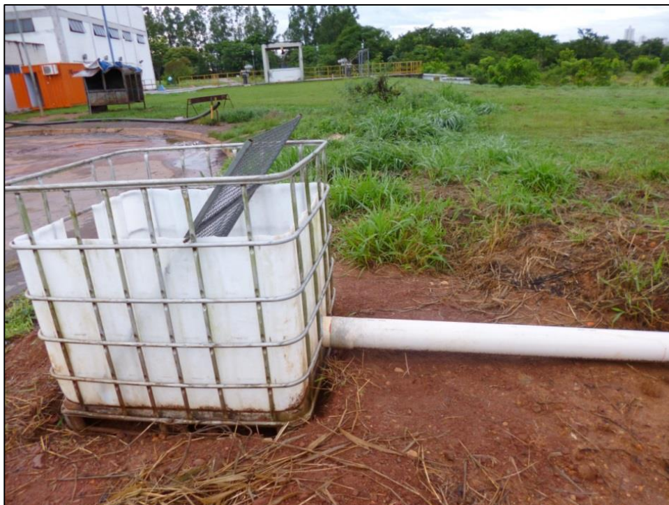
Figura 25: Caixa de recebimento dos resíduos que destina o material aos leitos de tratamento.
