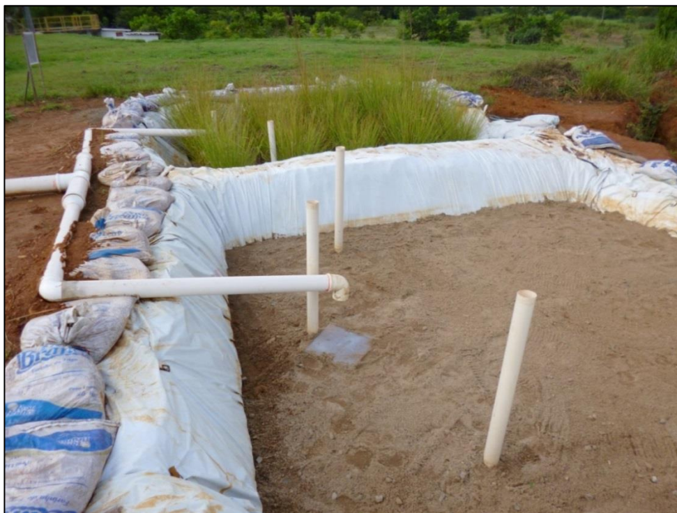
Figura 26: Imagem do sistema concluído e antes da primeira aplicação. Detalhe do sistema de divisão do volume do Resíduo de Fossa e Tanque Séptico a ser aplicado nos tanques de tratamento.
