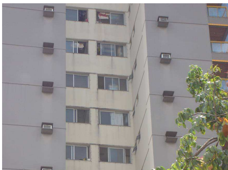
Figura 1.2 - Manchas de sujeidade próximas ao peitoril de janelas de edifícios na cidade de Goiânia
