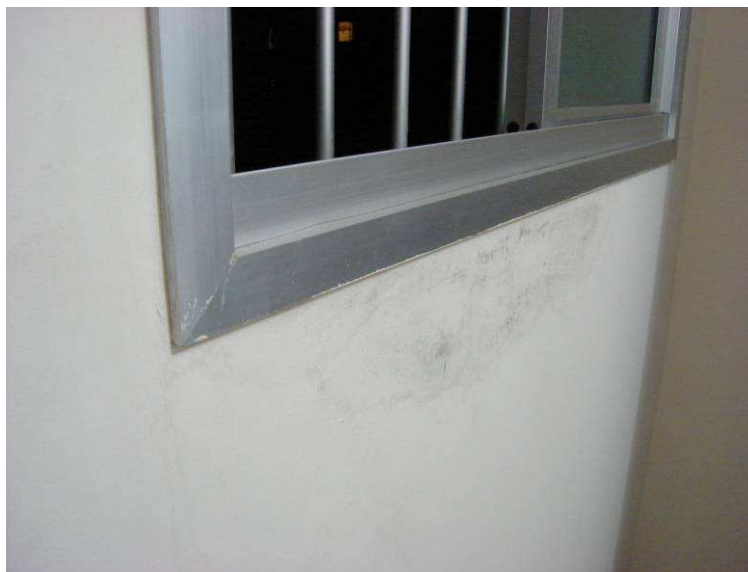
Figura 2.3 - Mancha interna devido à penetração de água através da esquadria presente na fachada
