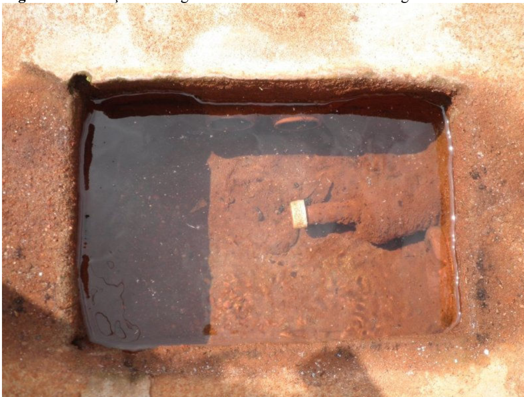
Figura 7: Presença de ferrugem no encanamento da caixa de água.
