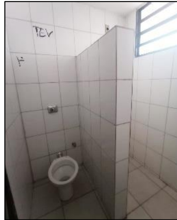
Figura 66 – Boxe com bacia sanitária no vestiário masculino
