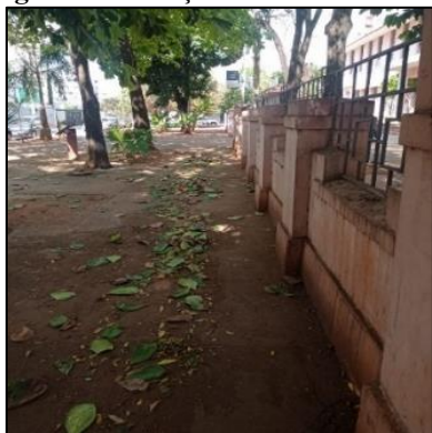
Figura 26 – Calçada em frente à escola
