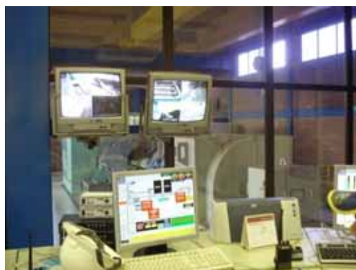
Figura 2.9 – Sistema de co-geração de energia elétrica (sala de controle). Foto: Janaina Silva
