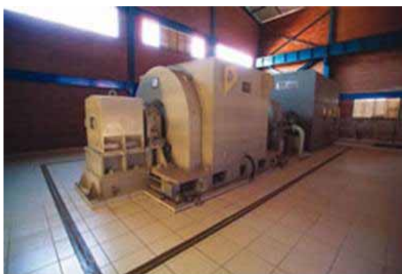
Figura 2.8 – Sistema de co-geração de energia elétrica (gerador) (FERNANDES, 2007)
