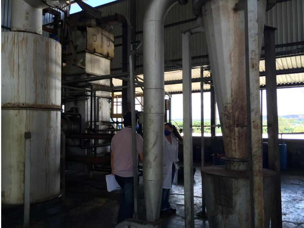
FIGURA 4 – Interior de uma empresa incineradora de Resíduos Especiais, instalada e licenciada em Goiás
