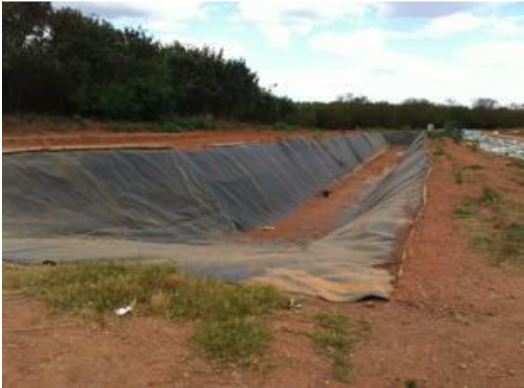
FIGURA 9 – Interior de vala séptica vazia para Resíduos de Serviço de Saúde. Aterro sanitário de Goianésia
