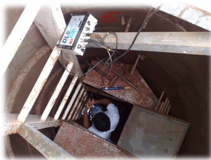
Figura 4.17: Instalação dos tensiômetros no campo
