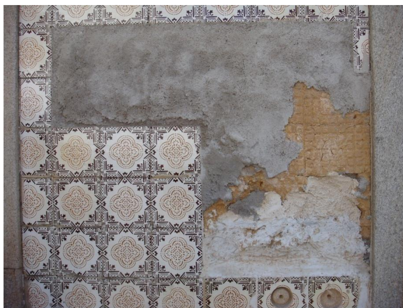
Figura 2. 7 – Uso inadequado de argamassa de cimento em fachada de azulejos em Ovar, Portugal (CARASEK; CASCUDO, 2010).
