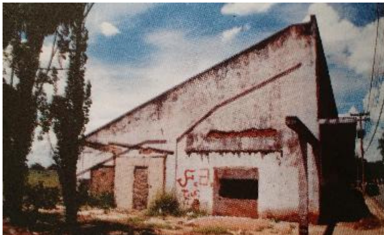
Figura 37: Arquibancada e muro destruídos no estádio em 2003. Fonte: TELES, 2005.
