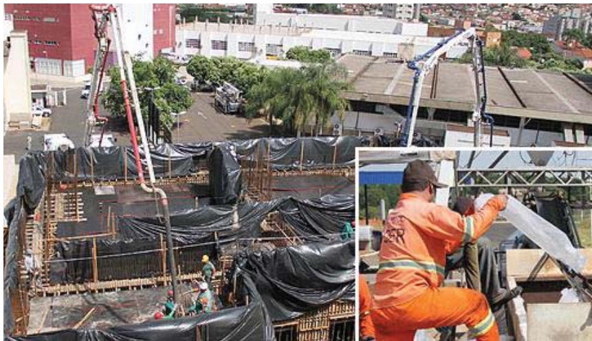
Figura 2.15 – Obra do Centro de Radioterapia de São José do Rio Preto e detalhe de adição de gelo à mistura do concreto utilizado na obra (FERRO, 2015).
