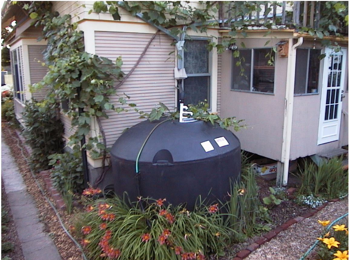
Figura 27. Reservatório individual superficial.
