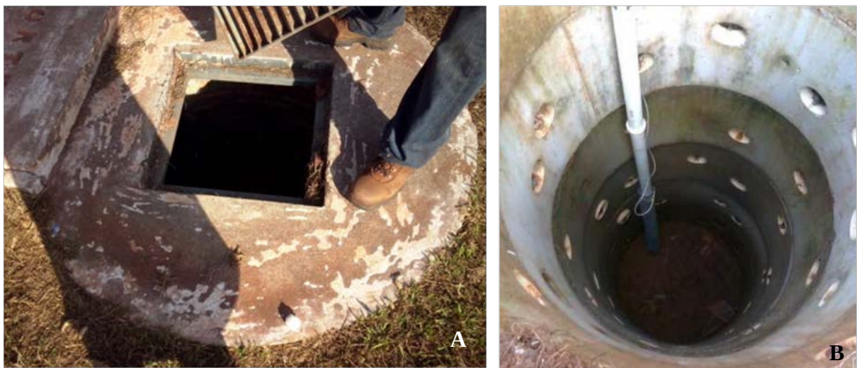
Figura 22. Poços de infiltração. A. Poço de infiltração no Campus Samambaia , UFG. B. Poço com manilhas em concreto perfuradas.
