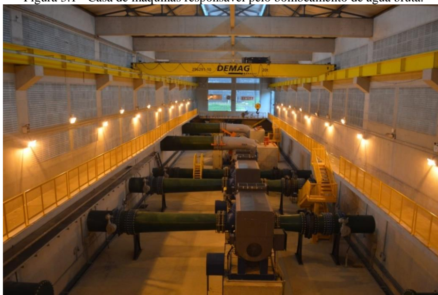
Figura 3.1 - Casa de máquinas responsável pelo bombeamento de água bruta.
