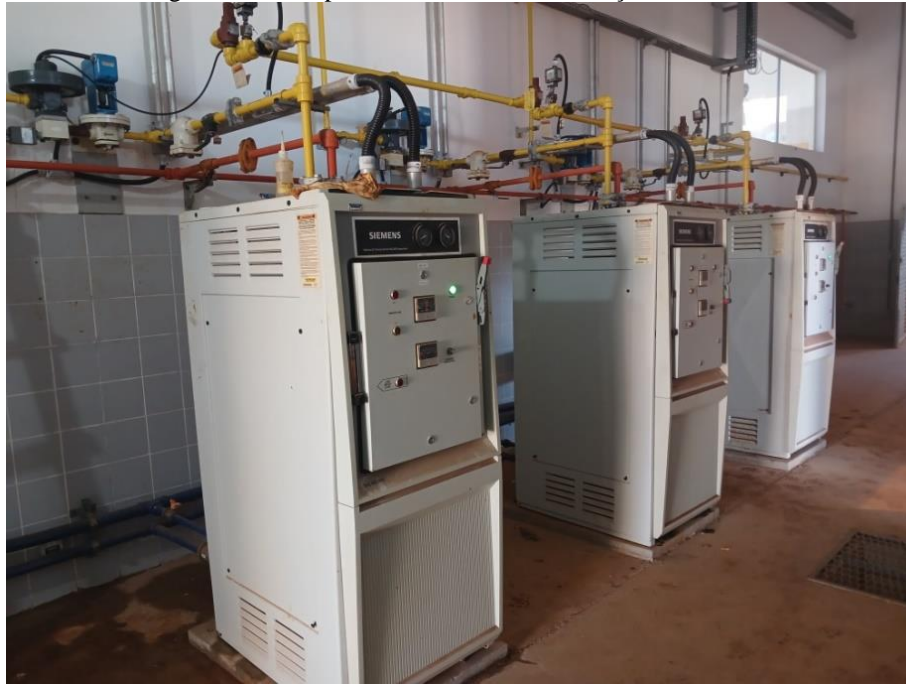
Figura 3.4 – Evaporadores de cloro e tubulações acessório.
