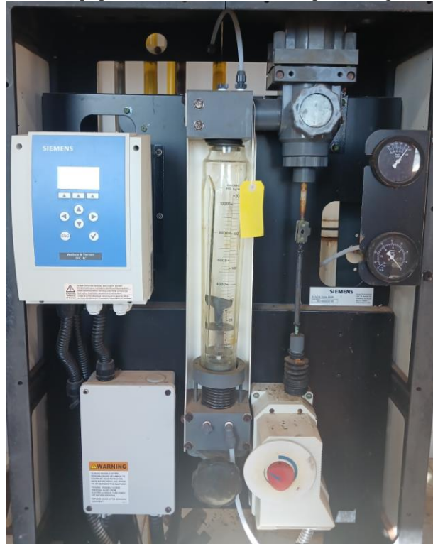
Figura 3.22 – Equipamento clorador, utilizado para dosagem de cloro.
