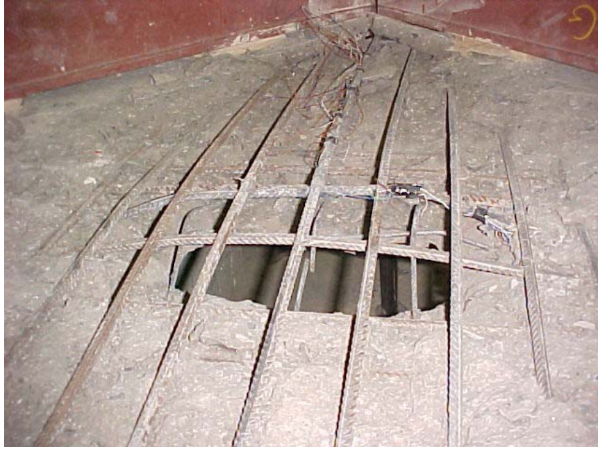
Figura G.13 – Armadura de flexão após a ruptura
