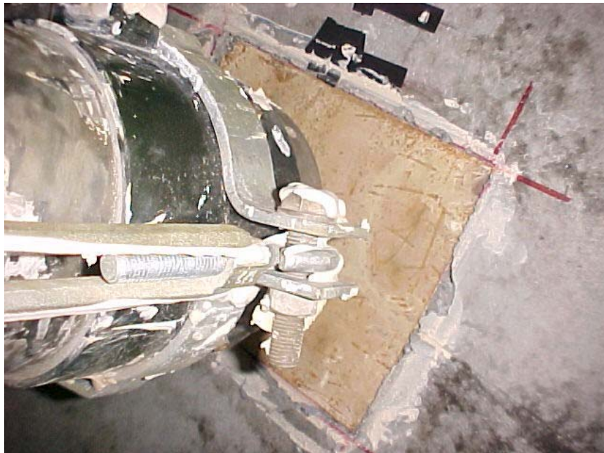
Figura G.14 – Superfície de ruptura da laje
