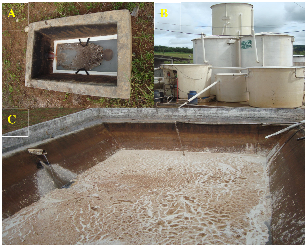
Figura 3. Visão geral da Estação de Tratamento de Efluente. A – peneiras; B – Tanques de tratamento físico-químico e biológico; C – Entrada do efluente no tanque de equalização
