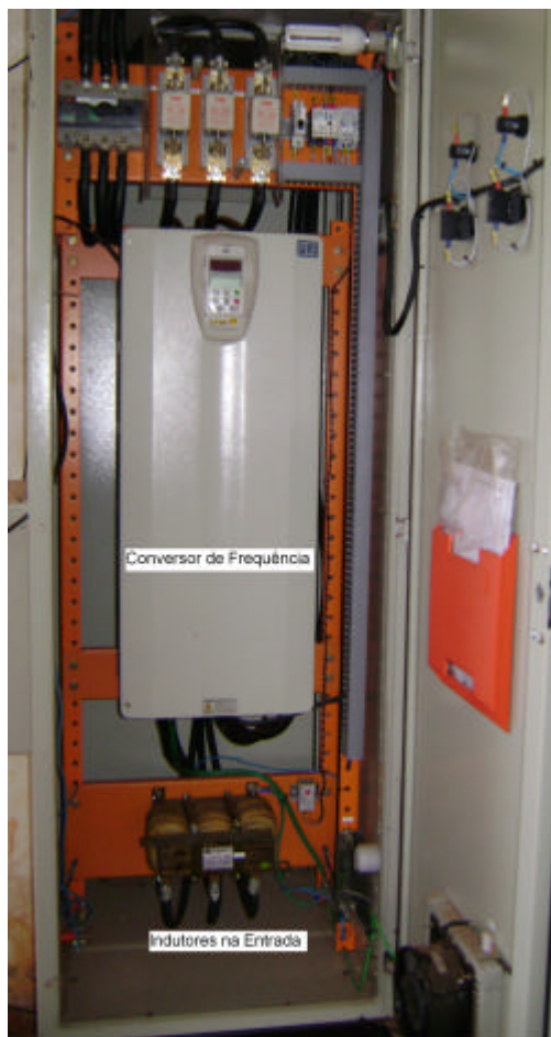
Figura 5. Conversor de frequência com reatâncias indutivas instaladas na entrada ( WEG, 2008).
