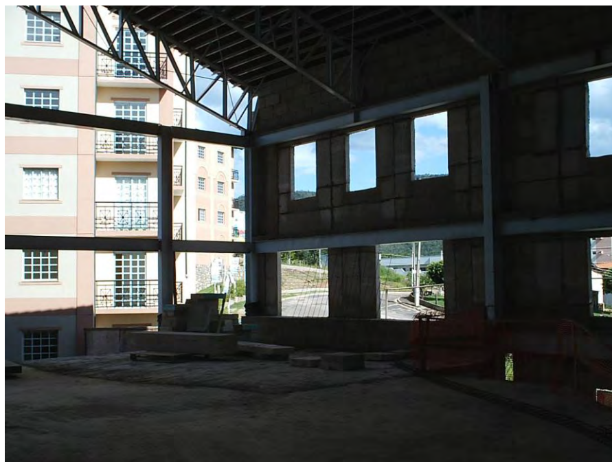
Foto 4.3: Foto da construção do Giardino Suítes. Detalhe da vedação externa em painéis de concreto celular, 2004.
